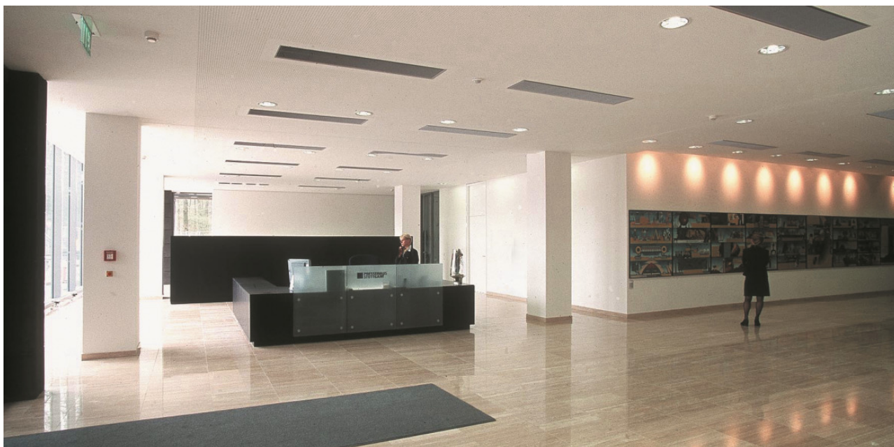
Systém INDUCOOL instalovaný v budově společnosti Pressehaus ve Stuttgartu
